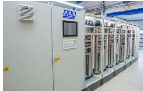
Fertige Schaltschränke für das Rommers
