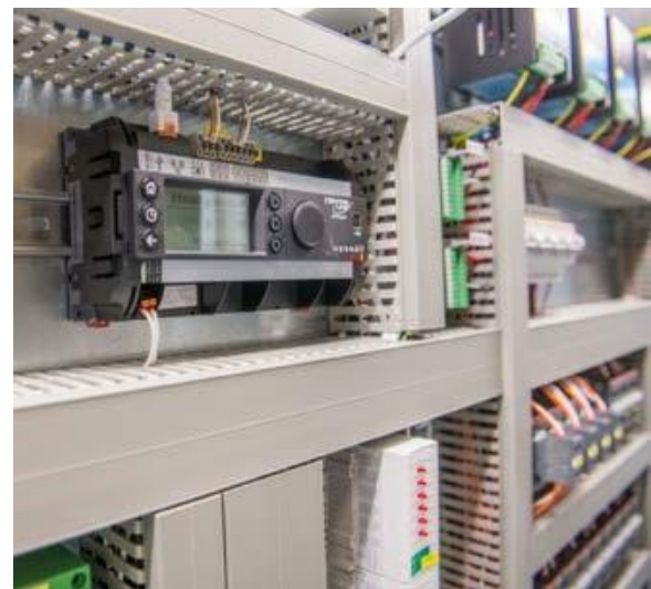
Innenleben eines Schaltschranks
